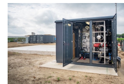
Biogas opwerking en invoeding in gasnet
